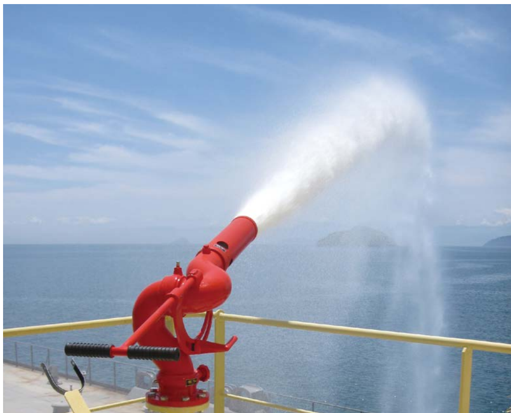
甲板泡消火装置フォームモニターからの放水試験
