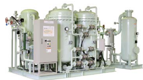
写真上／局所消火装置のポンプユニット 写真下／PSA式窒素ガス発生装置
