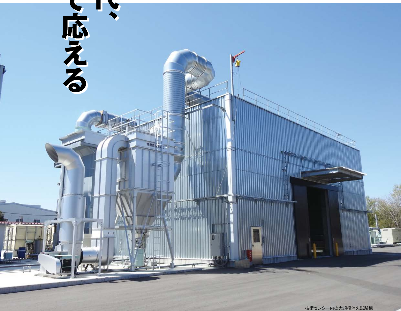
技術センター内の大規模消火試験棟
